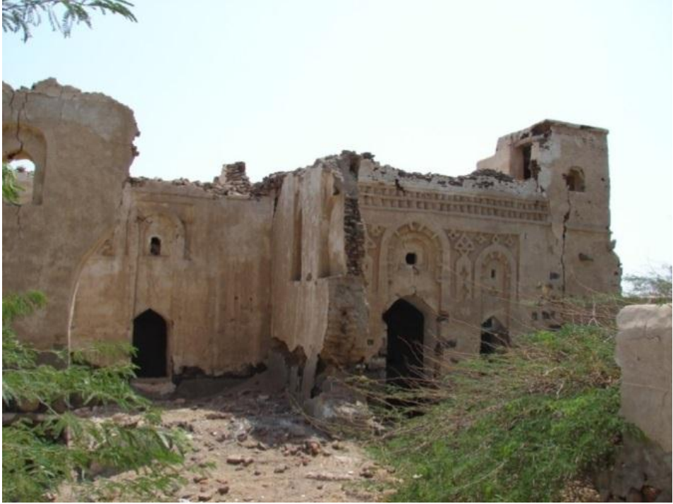
صورة رقم (5) واجهة غرفة الاستقبال وغرفة النساء بعد تهدم الجدار الفاصل بينهم، تصوير الباحث، 2010
